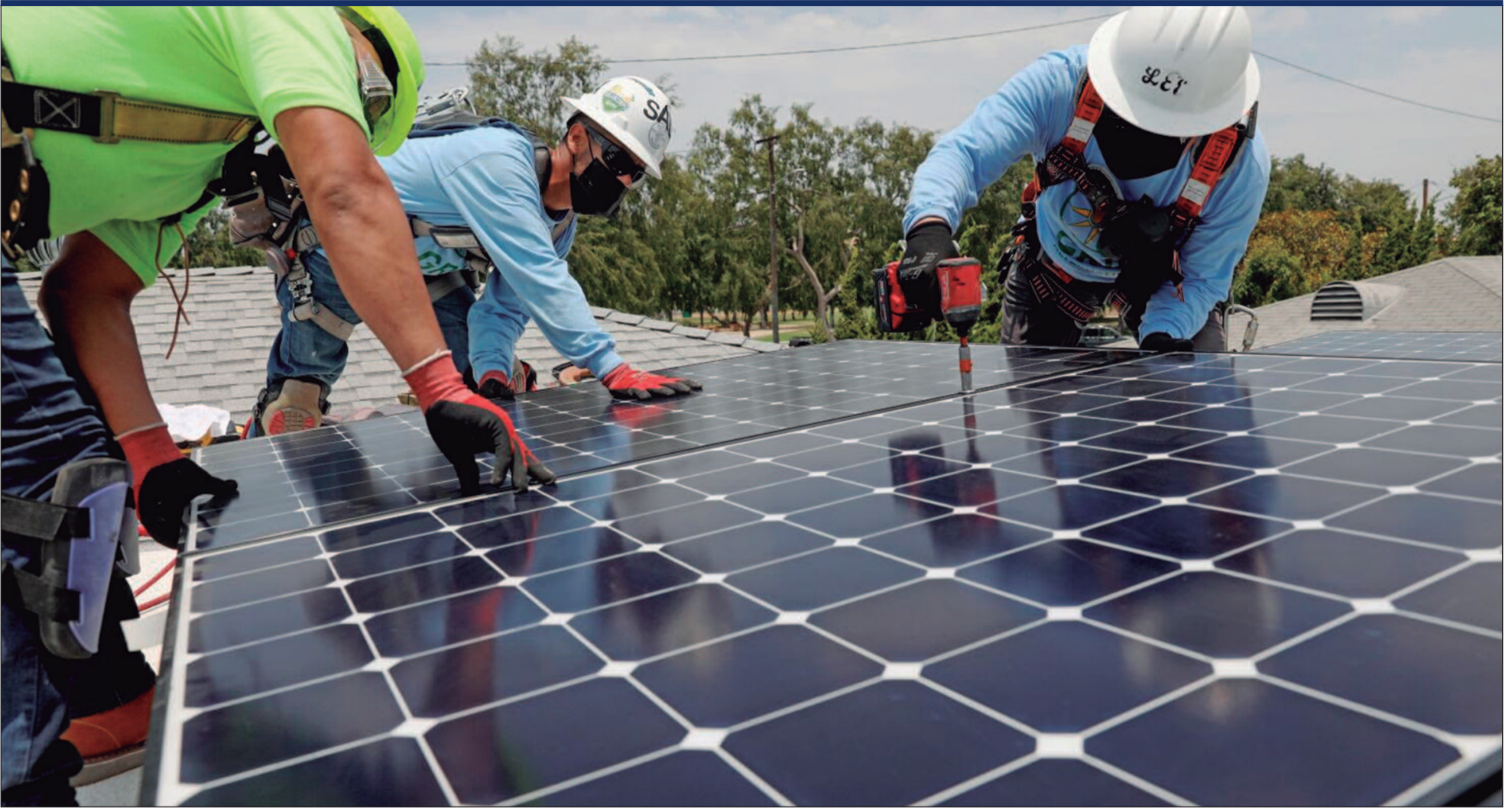
Após a instalação, os painéis solares convertem a luz solar em eletricidade, diminuindo a necessidade de recorrer a fontes convencionais
