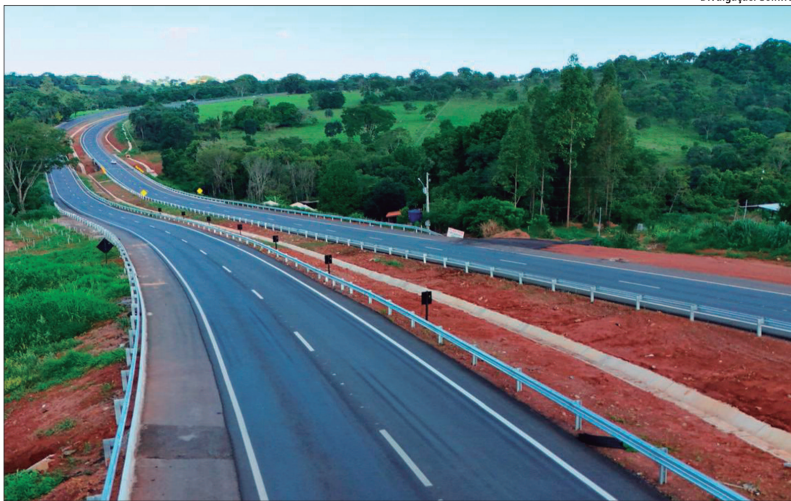
Goinfra segue com as obras de sinalização, da duplicação da GO-010, em Senador Canedo
