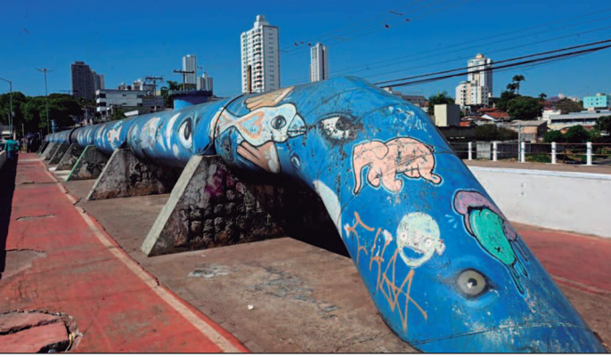
Ponte sobre o Córrego Botafogo está entre as estruturas que deverão passar por obras emergenciais após ordem judicial
