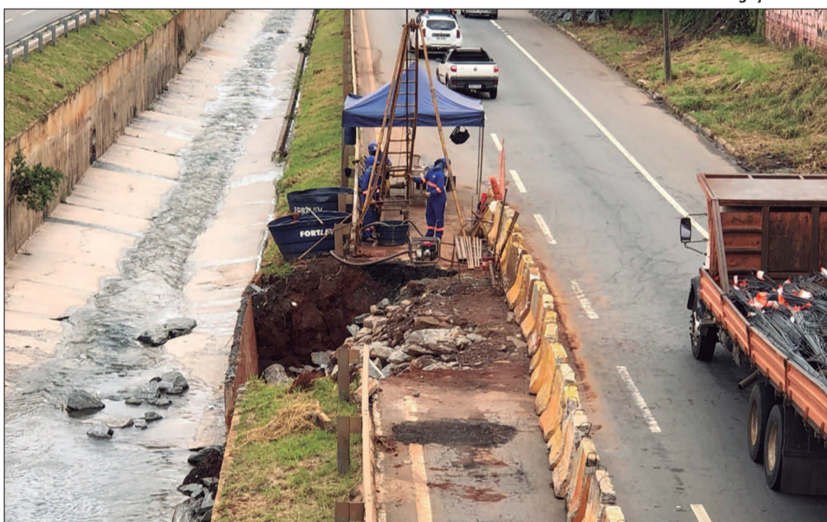
Obras na Marginal Botafogo devem ser iniciadas após sucessivos alagamentos e intervenções paliativas
