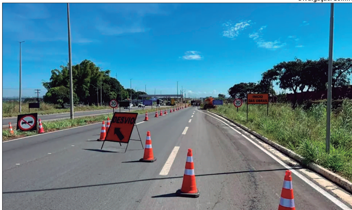
Obras de restauração da GO-020 começaram nesta semana e provocam mudanças no tráfego entre Goiânia e Bela Vista de Goiás. O investimento é de R$ 62,5 milhões e contempla mais de 30km da rodovia
