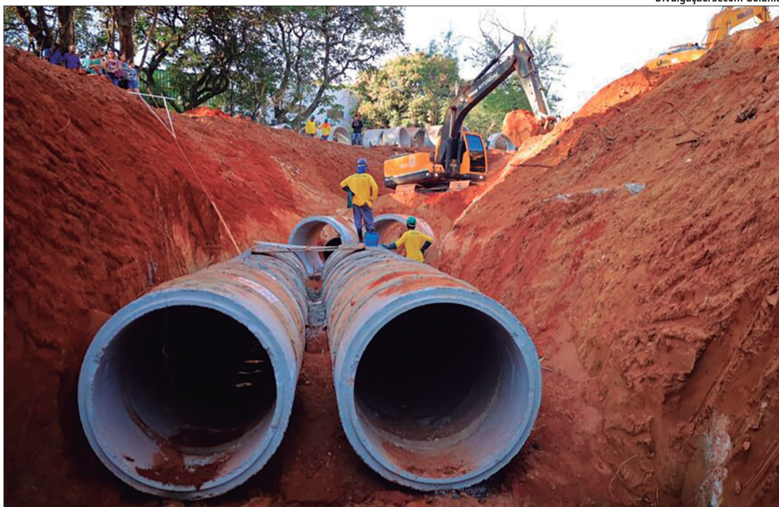
Plano Diretor de Drenagem prevê ações para os próximos 30 anos e projeta crescimento de 49% da área urbana de Goiânia até 2054
