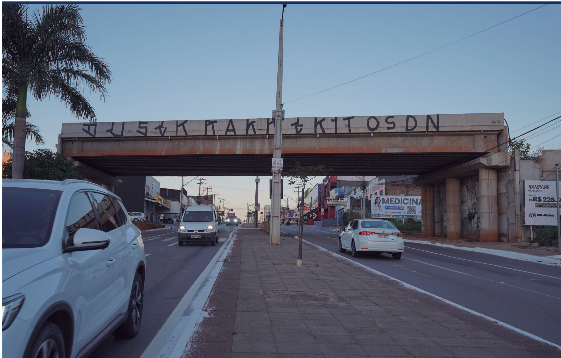
Prefeitura aguarda um novo laudo técnico para definir se o viaduto da Avenida Leste-Oeste poderá ser recuperado ou precisará ser demolido
